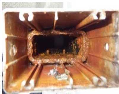
写真1.手すり支柱足元クラック状況
