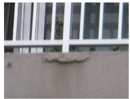
写真2.手すり支柱足元クラック状況
